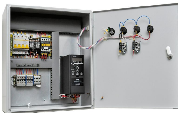
Рисунок 4 - Щит управления насосной станцией
